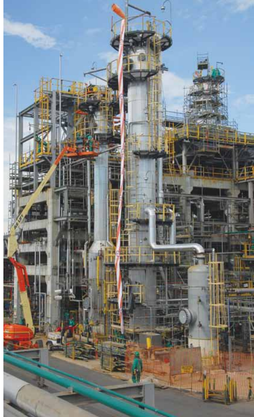
Planta de Hidrotratamiento en la Refinería de Barrancabermeja.
